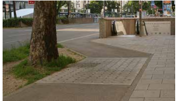
Zdjęcie 19 Płyta betonowa w ciągu drogi dla rowerów nad korzeniami drzewa. Niemcy
