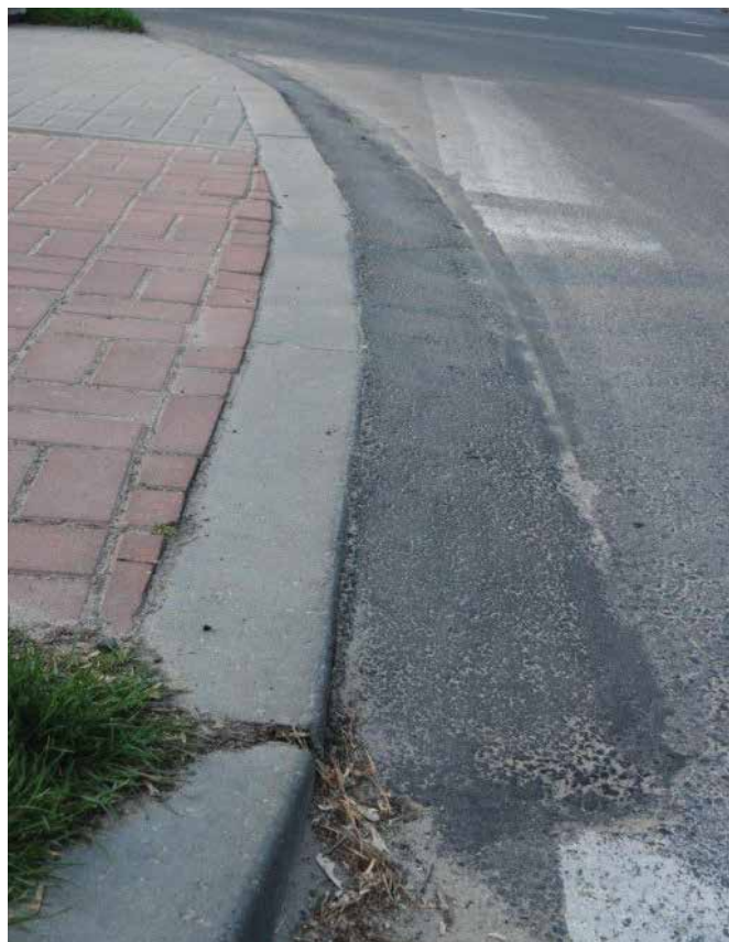
Zdjęcie 75 Wylewka z masy bitumicznej umożliwiająca wjazd na krawężnik – rozwiązanie tymczasowe. Wrocław, Polska
